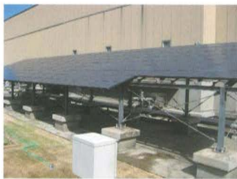
▲支柱の高い架台により設置 (九州電力大分支店)
