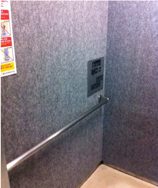
エレベーター室内
