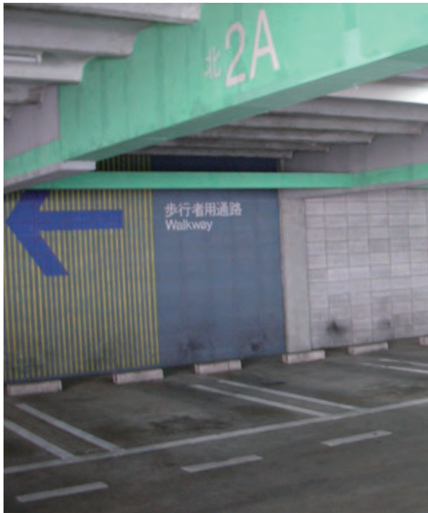
車室梁の階層色と外壁塗装色の混在
