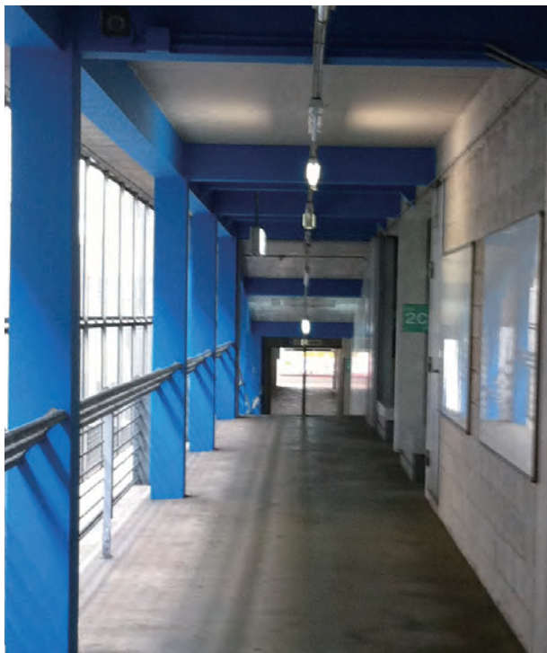
柱表示と通路内柱塗装色の混在（北棟 2F）
