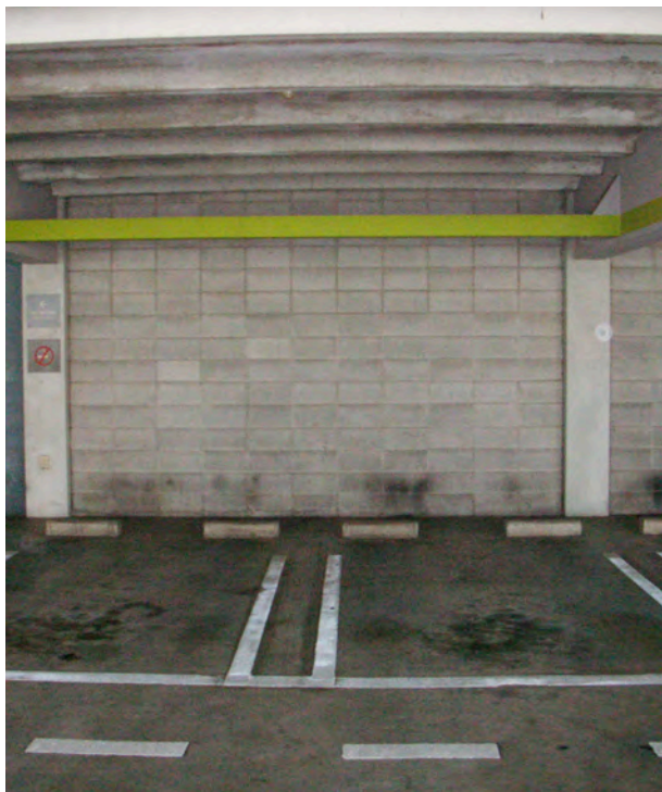
車室壁面案内表示（北棟 3F）
