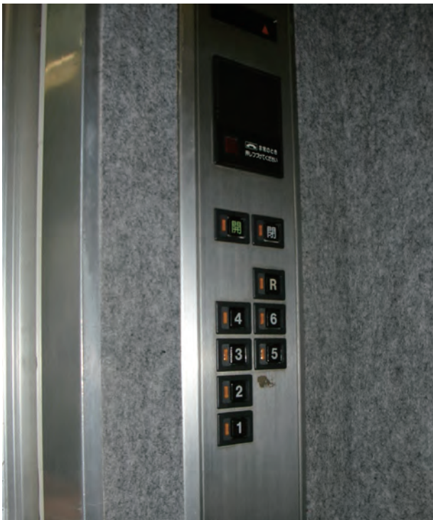
エレベーター行き先ボタン
